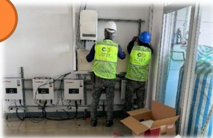
設置逆變器直流電轉交流電
