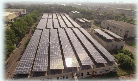
高雄市本洲工業區淨水廠1.4MW
